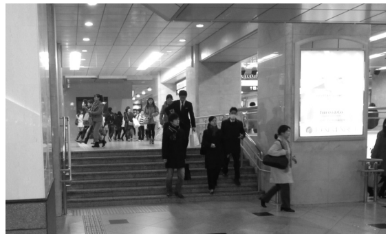
図2：JR大阪駅中央コンコースからサウスゲートビルディングに向かうところにある階段。地盤沈下の影響で段差ができた。
